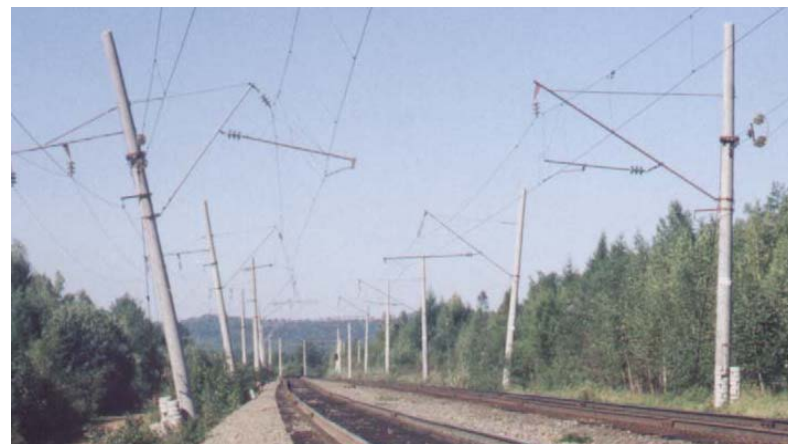
Деформации опор контактной сети Забайкальской железной дороги на участке Сегачама – Б. Омутная
