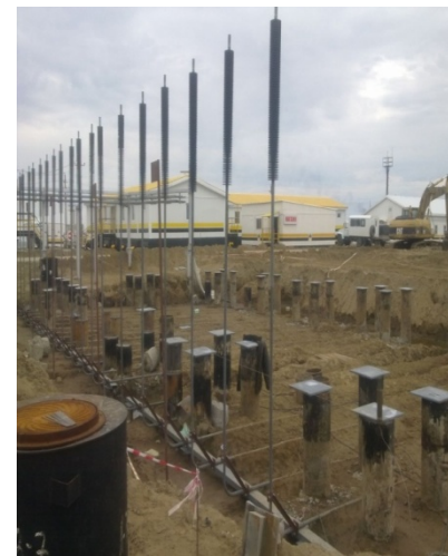
Система термостабилизаторов грунта на площадке Ванкорской группы месторождений
