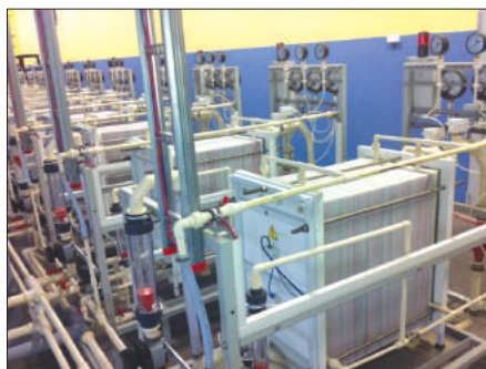
Фото 2. Промышленная электродиализная установка проточного типа
